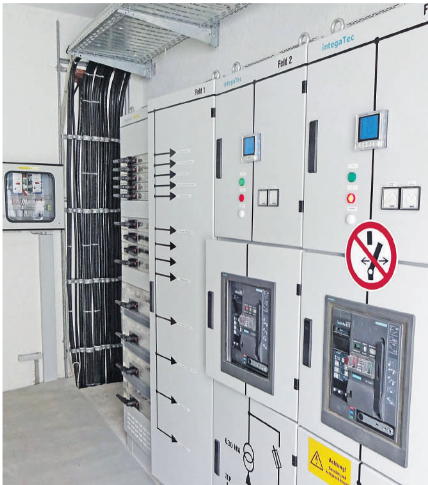
Komplexität im Gewerbebetrieb: Schaltschrank von Schrödl montiert
